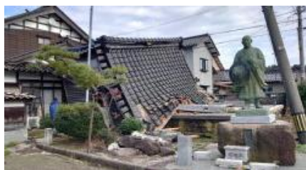
蓮如上人像と倒壊した鐘楼堂
