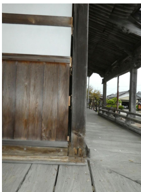
柱が折れ傾いた本堂
